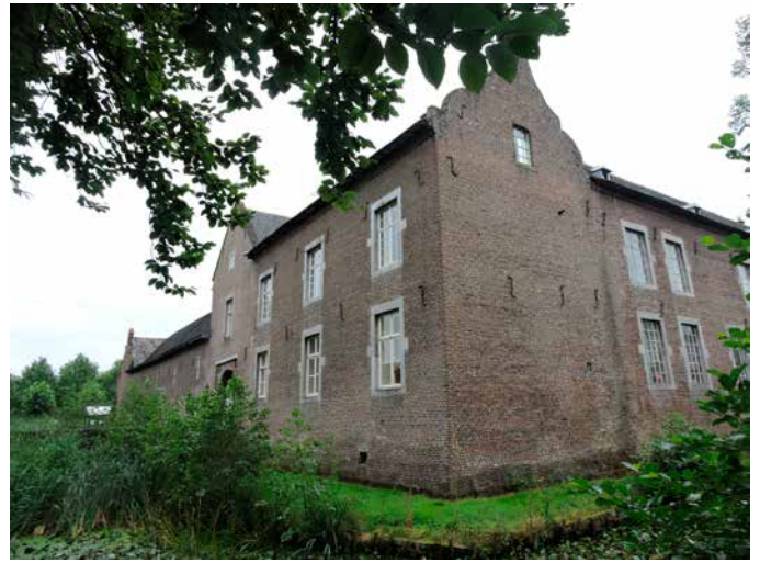
7. De noord-oosthoek met de lange, sterk gewijzigde noordgevel en een Gelderse topgevel als beëindiging van de haakse vleugel die bij de poort begint. Die gevel is op een venster op zolder na blind. Dat de haakse vleugel is opgehoogd is goed te zien aan de verhouding t.o.v. het dak van het poortgebouw. Dat dak had aanvankelijk de hoogte van de vleugel links van de poort, zoals aan ettelijke voorbeelden uit de streek is te zien. Bovendien is anders het effect van een poortgebouw dat immers moet markeren en imponeren er niet. Ook inpandig is dat te zien
