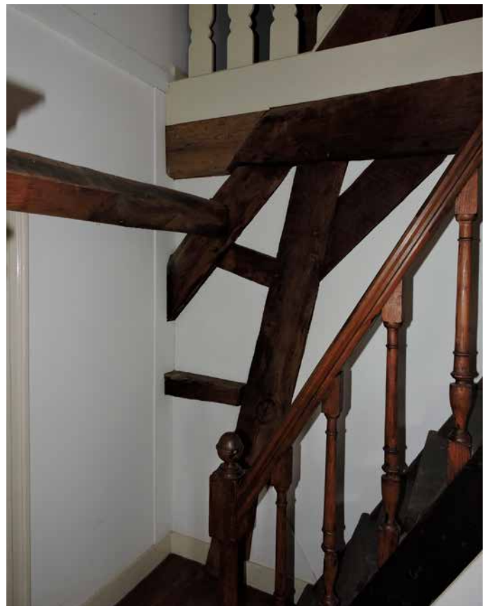
98. De oorspronkelijke helling en het dakvlak van het dak van de poorttoren zijn nog aanwezig achter de hoge, nieuwe aankapping van de spanten van de rechter vleugel
