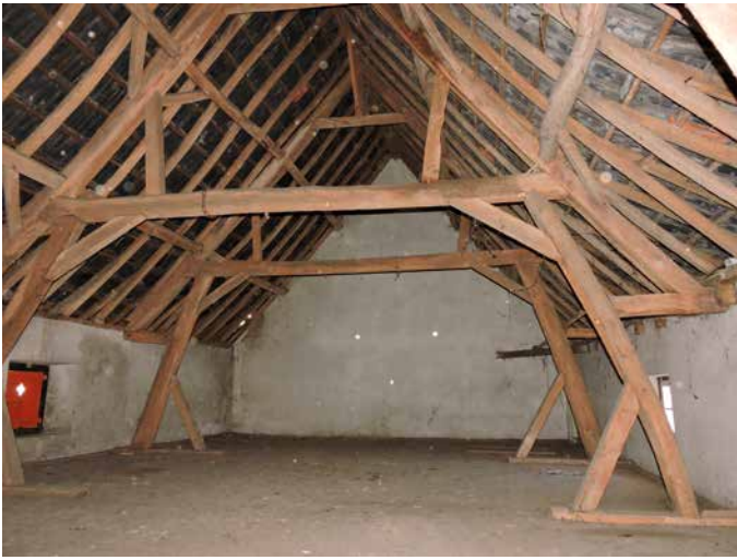
204. De zolder met de kapconstructie die licht afwijkt van de rest maar wel als gordingkap is uitgevoerd. De spantbenen lopen hier verder door naar beneden en rusten op de vloer i.p.v. op een moerbalk
