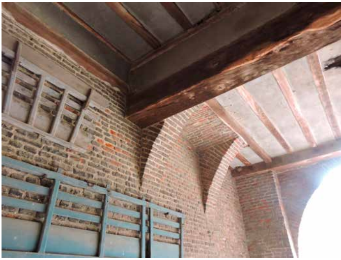
62. In de zoldering is de opvangconstructie van een haard met stookvloer te zien van de kamer boven de poort
