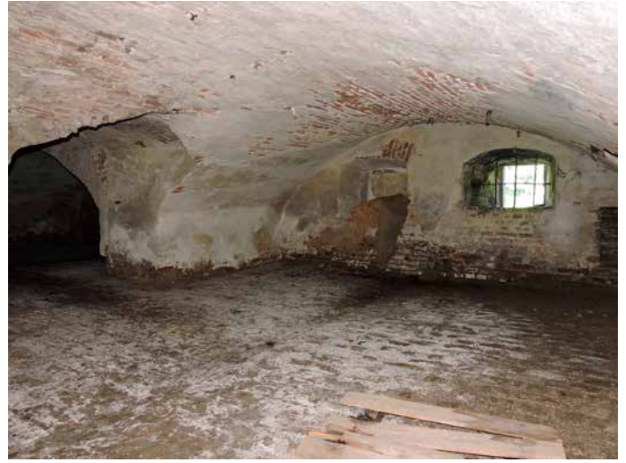
116. De gedrukte gewelven en de gebruikte baksteen wijzen op een ontstaanstijd eind 18 de eeuw. Daarbij zijn de buitenmuren blijven staan. Die laten dan ook openingen naar buiten zien die al bestonden en al dan niet zijn dichtgezet, of nieuwe die toen zijn gemaakt
