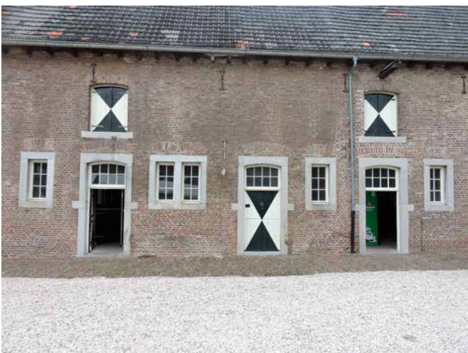
44. Alle openingen zijn nieuw en vervangen rechts een van de voorgaande drie poorten van de remis annex wagenloods
