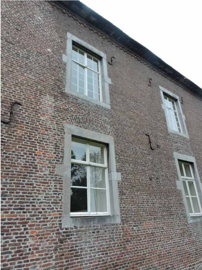
6. De ramen zijn van hout en hebben een kalf en een vast, gedeeld bovenlicht. Er zijn geen aanwijzingen dat de omlijsting oorspronkelijk kruiskozijsen vormden
