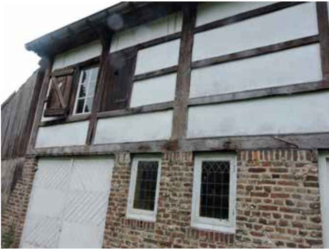
17. Zowel het metselwerk als het vakwerk van de noordgevel zijn vernieuwd. Bij het vakwerk valt op dat de vakken terugliggen t.o.v. het houtskelet, wat lijkt te wijzen op binnenzijdig opgespijkerd Kempisch vakwerk. Dat is er echter niet maar kan wel de gedachte zijn achter de uitvoering. Er zijn geen toognagels, een extra indicatie voor de vernieuwing van het vakwerk
