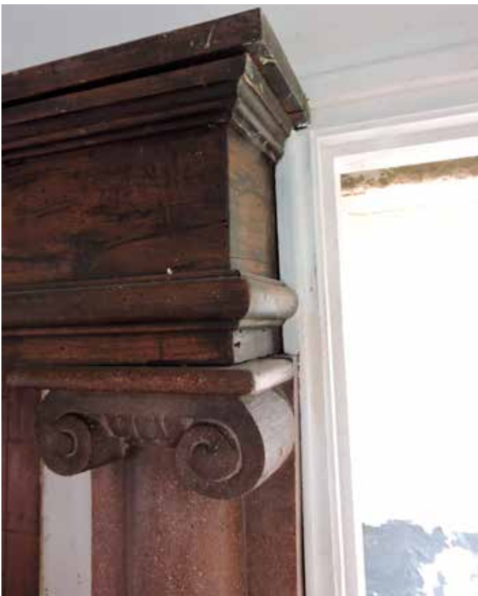
23. De vormgeving daarvan doet zeer historisch aan maar is wat de kap betreft een vrij goede imitatie van gebruikelijke kappen uit de omgeving. De haardwangen met hun dorische bekroning is zijn dat niet, en is zijn uitgevoerd in kunststeen die gepolijst is en sterk lijkt op Hollandse voorbeelden. Het ligt dan ook in de rede om aan te nemen dat die door Smits, als eigenaar en verbouwer, is aangeleverd
