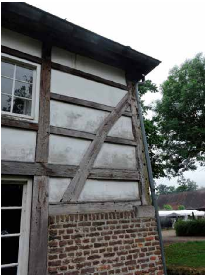
21. De hoek van het vakwerkgedeelte is deels met hergebruikt hout opnieuw gerealiseerd zoals niet alleen blijkt uit het oppervlak van het gebruikte hout maar ook uit het ontbreken van getoogde verbindingen
